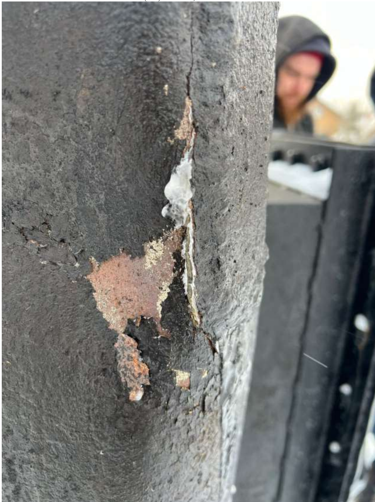
Фото 2. Следы коррозии и отслоение отделочного покрытия.
