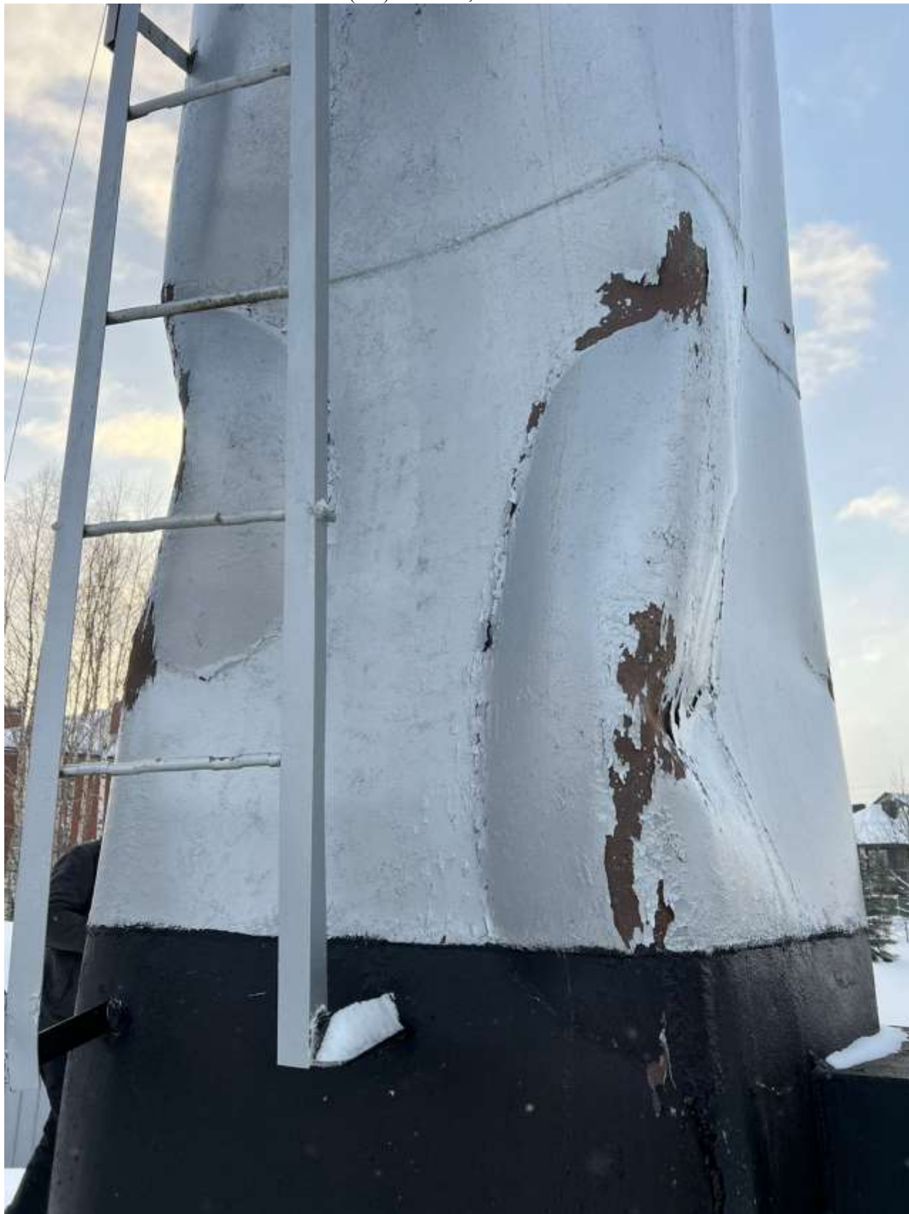
Фото 1. Деформация водонапорной башни.
